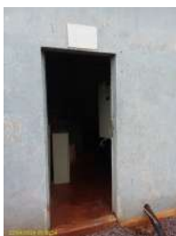
Foto 3 - Placa de identificação desgastada.
