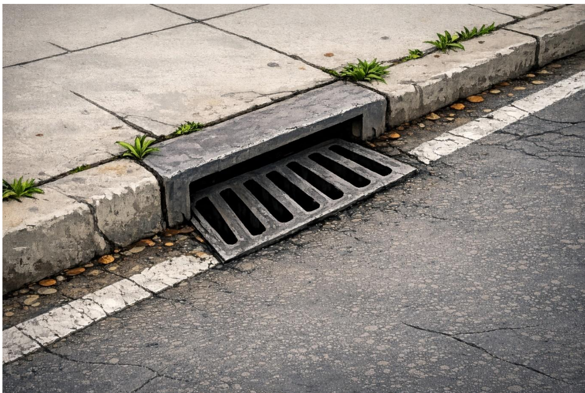
Figura 02 – Boca de lobo
